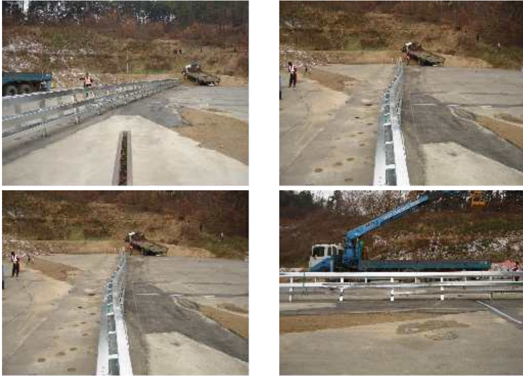
[대형차 충돌 후 중앙분리대의 변형상태]
