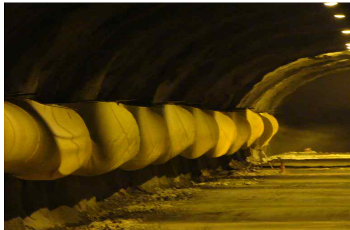
그림 53 기존 터널 공사현장에서 사용하는 송기용 배관
