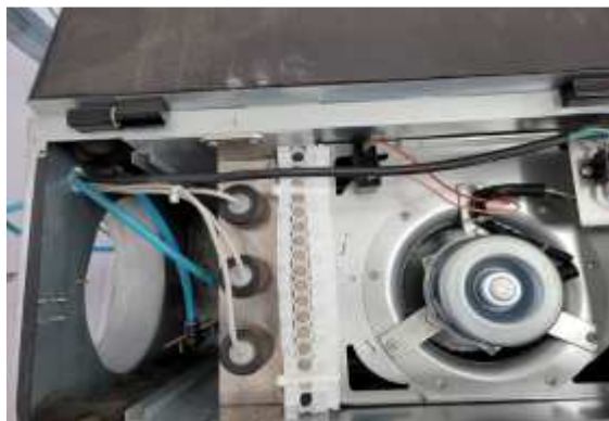
그림 91. 시작품 내 다공성 콘크리트 필터 장착
