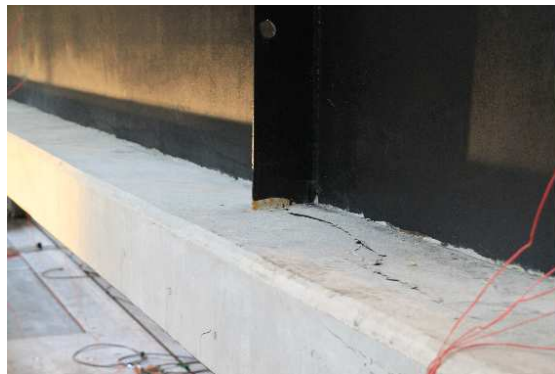
(b) 케이싱 콘크리트 상면 파괴
