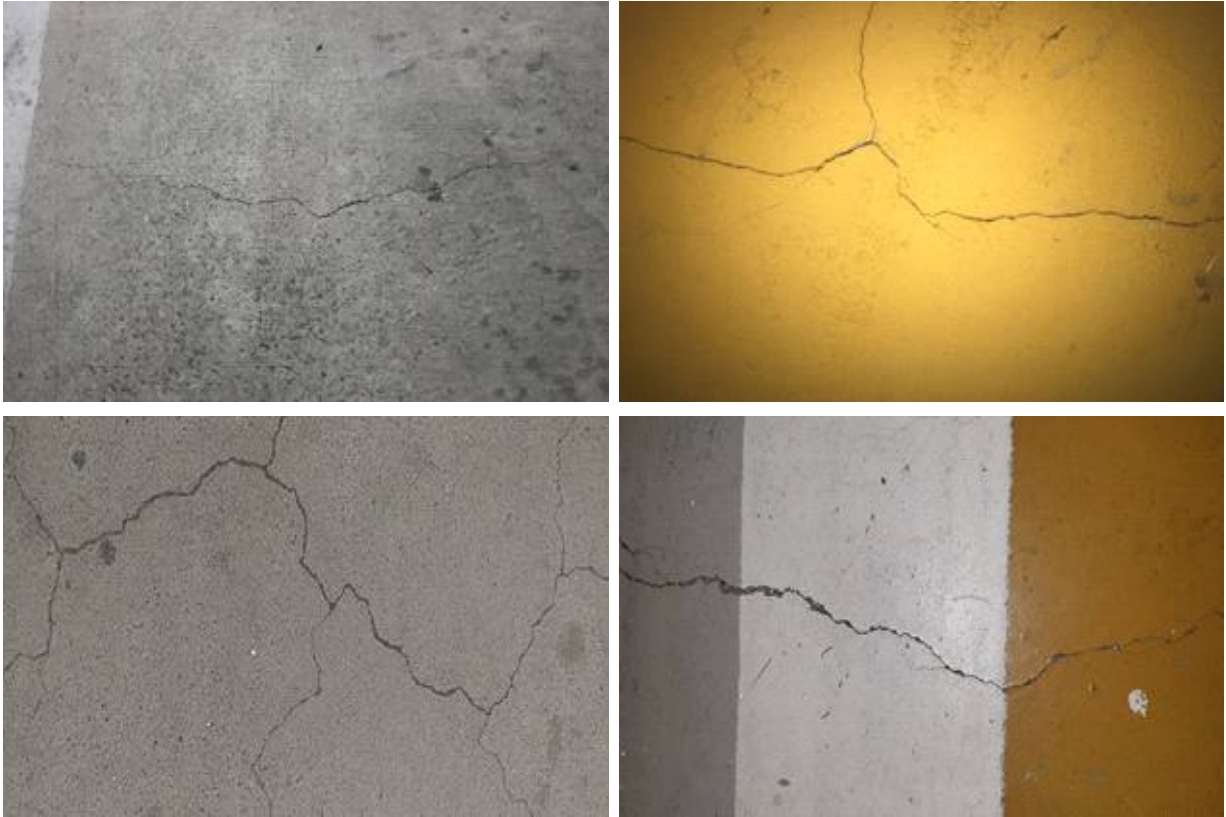
그림 2-13. 1차년도 균열 데이터 예시
