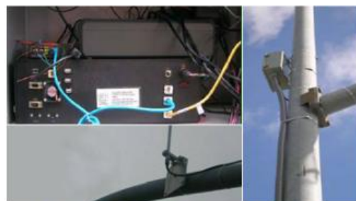
Intelli-Drive 현장시험 구성장치
