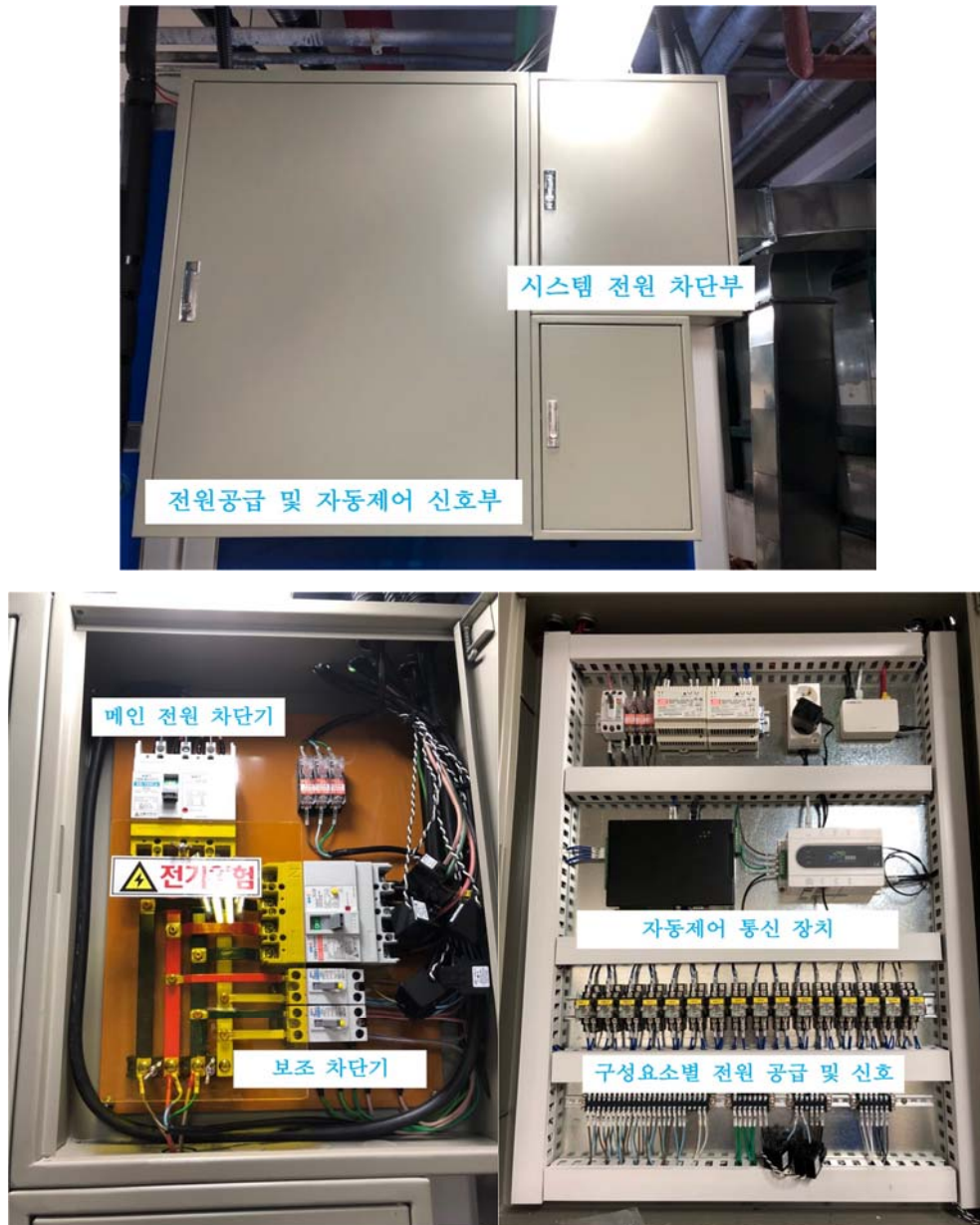
그림 139. 테스트베드에 구축된 시제품 유닛 전원 및 자동제어 신호 처리 설비
