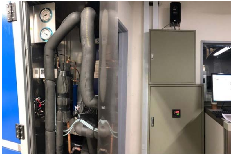
그림 134. 히트펌프 구축 사례 및 인버터 드라이버 설치
