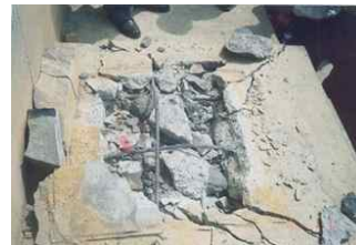
(b) 받침부 파괴 및 교좌장치 탈락
