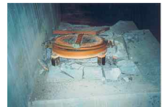
(c) 받침부 파손
