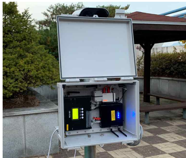
<함체 내부에 설치된 부품 (게이트웨이, LoRa 통신 모듈 등)>
