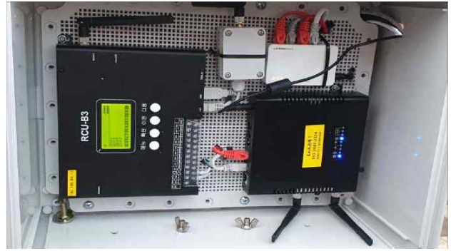
(c) 현장 설치 완료 후 현장 기기 램프 확인
