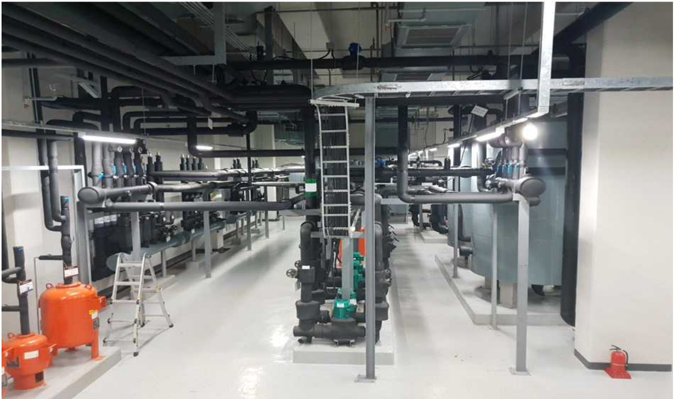
노원 에너지제로주택 기계실 (개선공사 완료)
