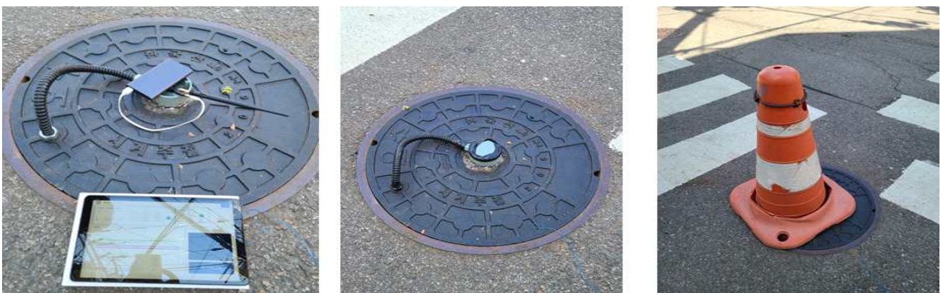
[그림 3.8] 맨홀 내 장치로부터 데이터 정상 송수신 확인 및 설치 마무리 모습
