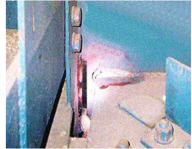
l. 거세트판 연결 복부판 균열
