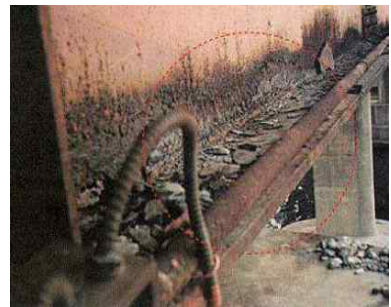
f. 신축이음 하단 거더 부식
