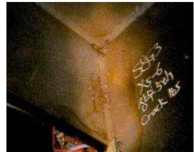
c. 용접교차부 균열
