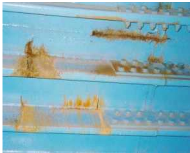
a. 용접부 균열
