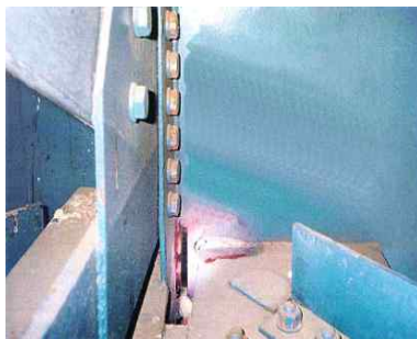
a. 거셋판 용접부 균열
