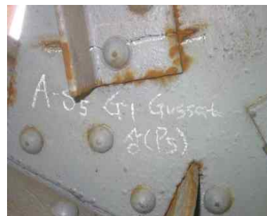
e. 거세트판 균열
