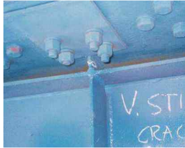
k. 수직보강재 균열
