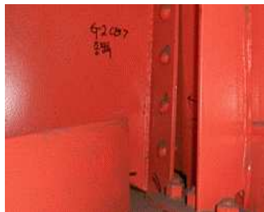
e. 가로보 연결부 들뜸
