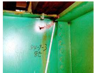
c. 연결 절취부 균열
