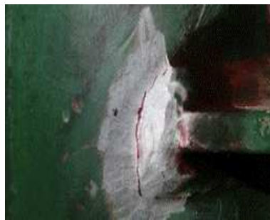
b. 거더-가로보 연결부 균열
