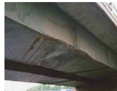
f. 박스 충격 파손
