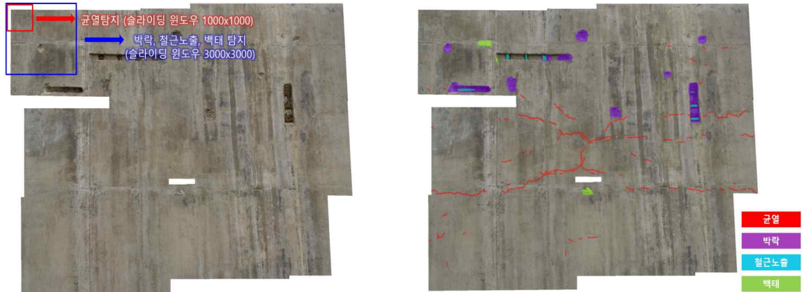
콘크리트 외부 시험체 전면부 이미지 및 손상 탐지 결과 (해상도 14218 x 10645)
