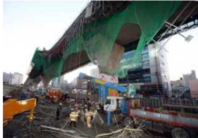
(b) 부산 남북항대교 연결도로 붕괴 (2013)
