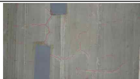
균열 탐지 일부 (30번 교각)
