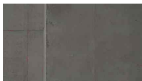
균열 탐지 일부 (바닥판 및 거더외부)
