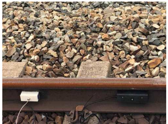
레일에 설치된 좌굴 및 절손센서
