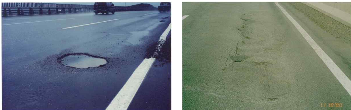
〈그림 1.2〉 도로 포장 파손
