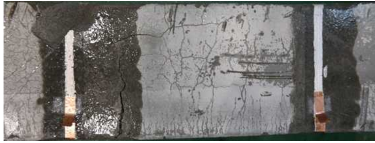
Fig. 44 - 강섬유 보강 시멘트 복합재료를 부분 타설한 철근 콘크리트 빔의 휨 인장 하중 하에서의 미세균열 거동
