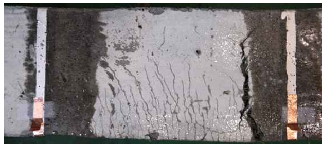
Fig. 42 - 강섬유 보강 시멘트 복합재료를 전체 타설한 철근 콘크리트 빔의 휨 인장 하중 하에서의 미세균열 거동
