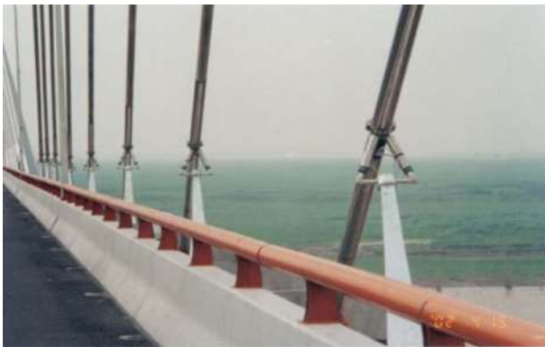
그림 18. 동팅호 사장교에 설치된 자기유변댐퍼의 모습 [27]
