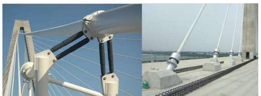
그림 7. 장대교량 케이블에 설치된 수동식 댐퍼 (좌: Arthur Ravenel Jr. Bridge, 우: 화명대교)
