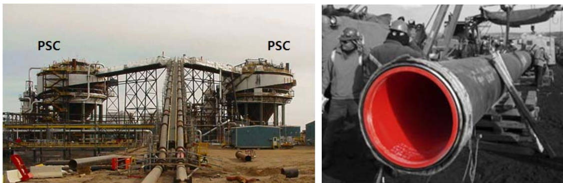
[그림 2.28] Hydrotransport Pipeline (HP)
