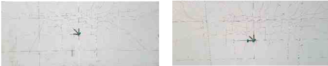
[실험체 균열 형상]
