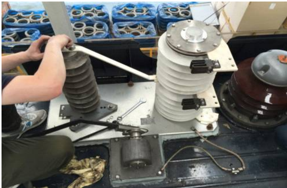
<주회로차단기 설치 사진>
