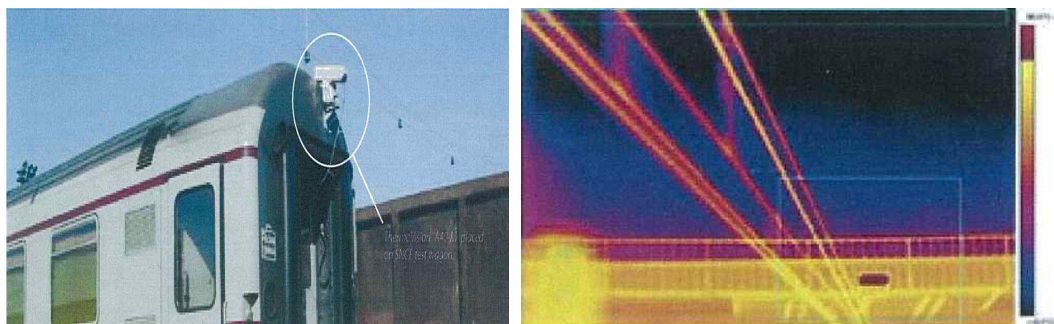
[그림 2-12] 차량 위에 설치된 적외선 카메라와 전차선 열화상 이미지
