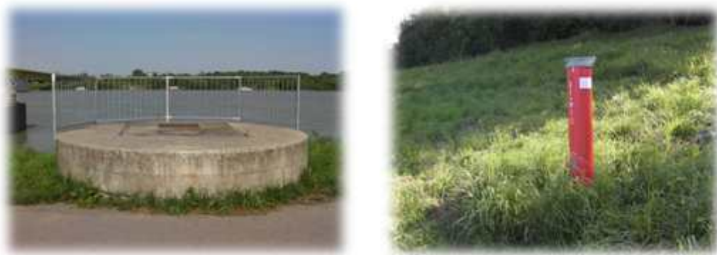
그림 2.83 오스트리아 비엔나 다뉴브강변에 설치된 지하수 양수정 및 관측정
