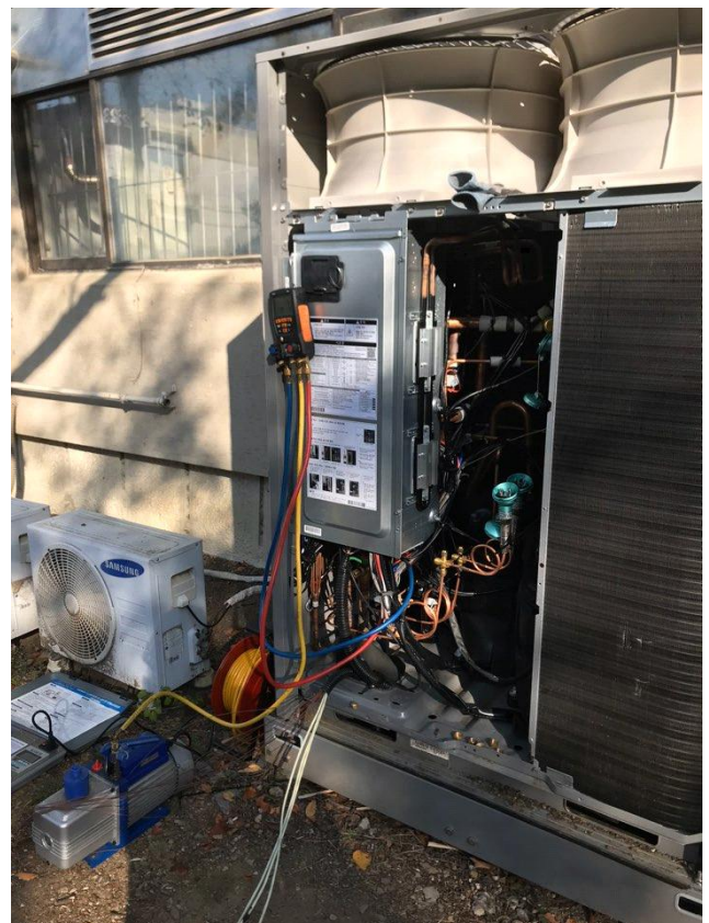
[공랭식 히트펌프 실외기 모니터링 센서 추가설치]
