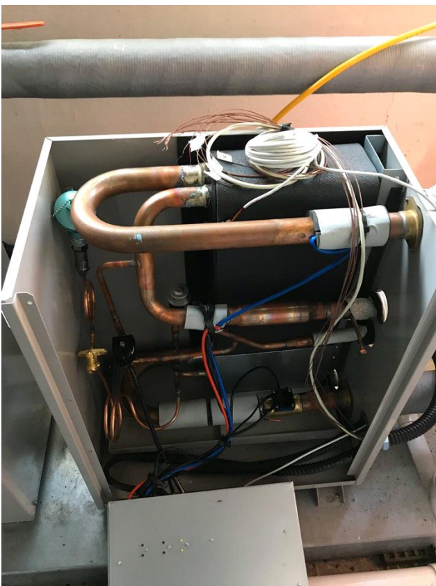
[공랭식 히트펌프 실내기 모니터링 센서 추가설치]
