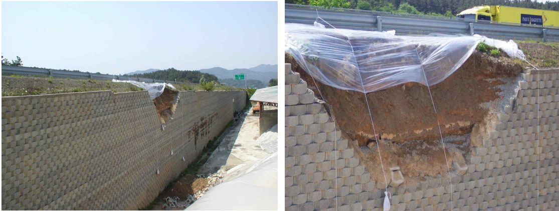
그림 3.1.19 OO도로확포장 공사 보강토옹벽의 피해모습
