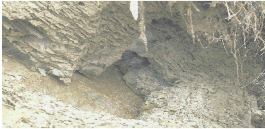
그림 3.1.12 사면 보강용 숏크리트의 동결융해에 의한 파손
