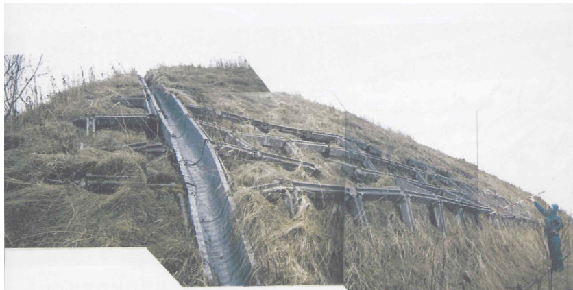
그림 3.1.11 절토사면 보강용 콘크리트 격자틀의 파손
