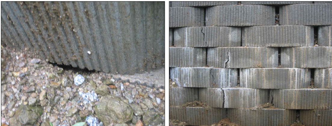
(기초부 세굴현상 및 벽체침하, 균열현상)
