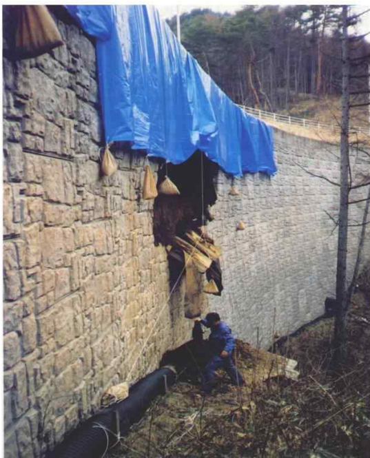
동상현상에 의해 콘크리트 패널이 떨어져 나갔으며, 내부의 토사도 같이 20cm 정도가 붕락되었음
