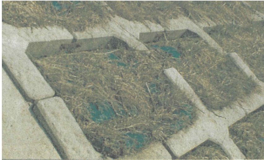
그림 3.1.10 동결융해에 의해 파손된 콘크리트 격자틀
