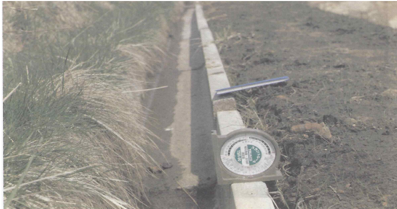
그림 3.1.14 절토사면 소단 배수로의 동상 융해 피해
