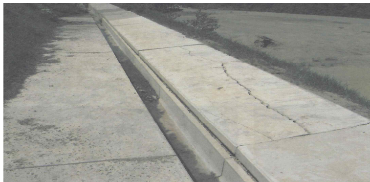
그림 3.15 하부지반 동상으로 파손된 배수로 앞 콘크리트판
