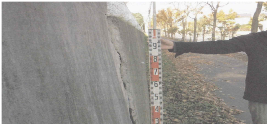
그림 3.1.13 북해도 키타미공대에 설치된 옹벽의 동결융해에 의한 파손
