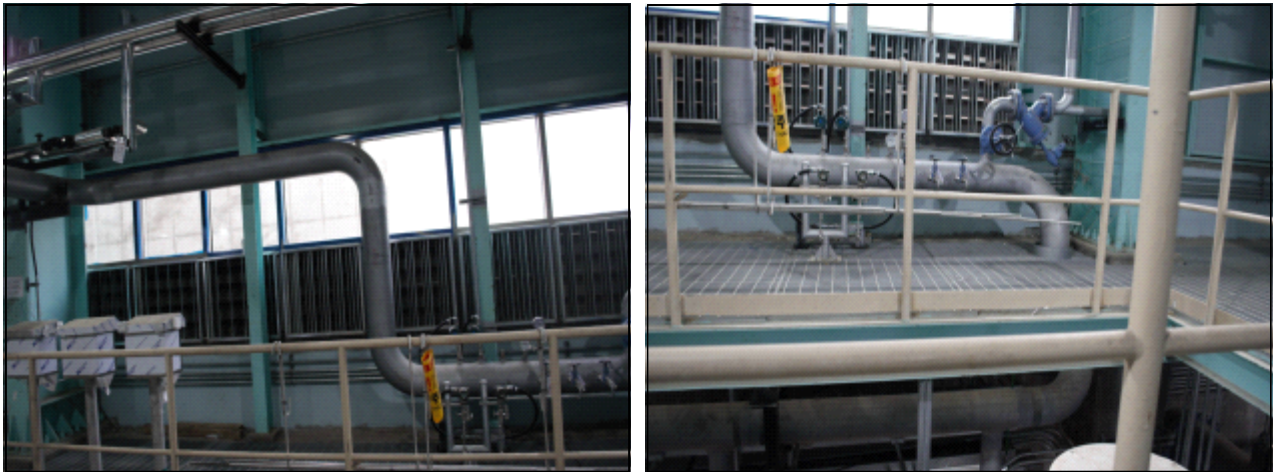
(a) (b) <그림 3-3-19> 포천열병합발전소 내 응축기 시스템 (a) 대상 구역의 일부 사진, (b) 시공오차 측정 영역
