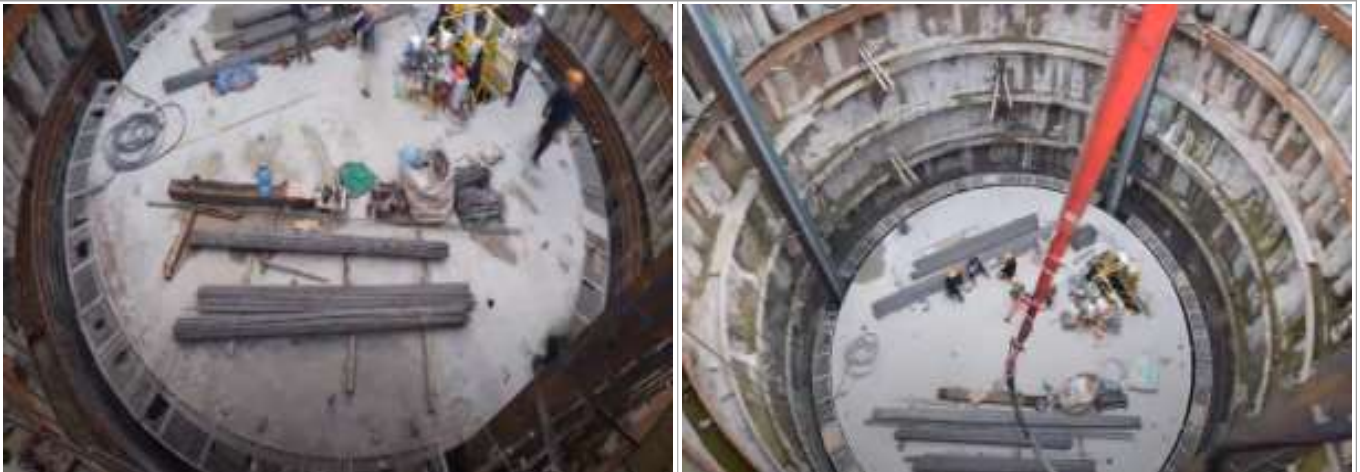
그림 32. 직경 6.8m 슬립폼에 설치된 유압실린더 14개 유압오일 분배가 어렵다
