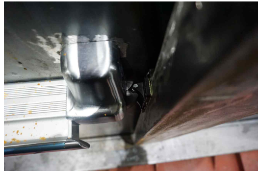
exit device 걸림 상태
