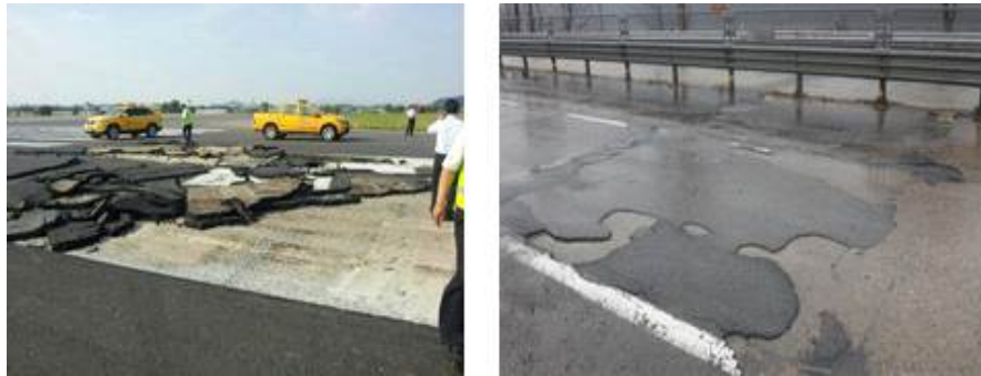
<그림 3-26> 두 층 사이 부착 미비에 따른 아스팔트 덧씌우기 파손 사례
