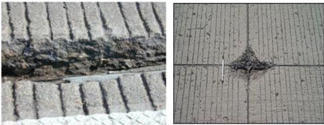
<그림 1-3> 줄눈 콘크리트 포장(JCP)에서 발생한 스폐링
