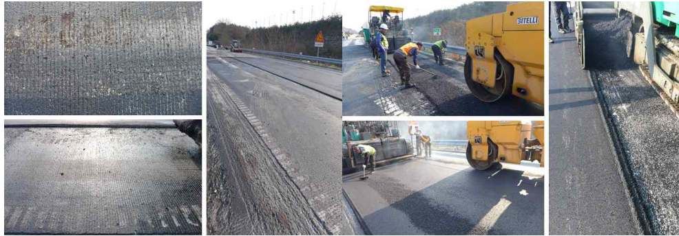
<그림 3-49> Tack Coat 양생 시간 <그림 3-50> F-DGM 혼합물 포설 및 다짐 시공 시 문제점 부족으로 인한 문제점 다짐 시공 시 문제점
