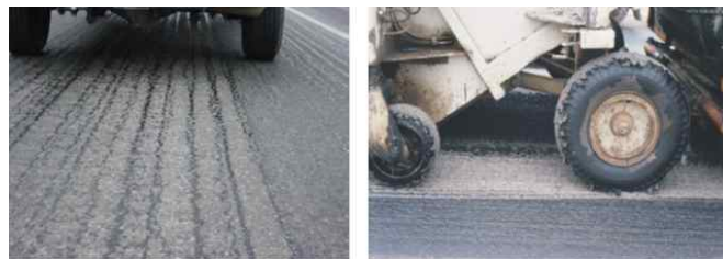
<그림 3-27> 중 차량 타이어에 의한 Tack Coat 재료의 파손
