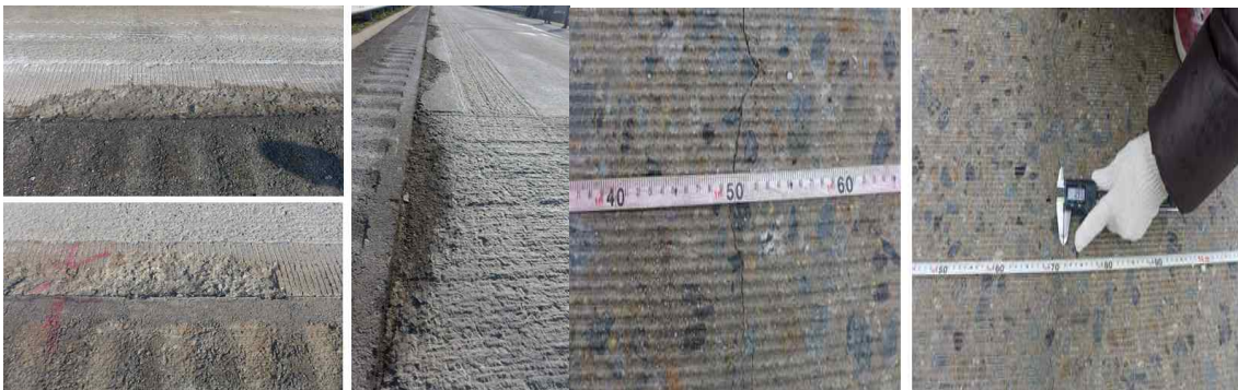
<그림 3-38> CRCP 포장 파손 육안 조사 <그림 3-39> CRCP 표면 균열 간격 및 균열 폭 측정
