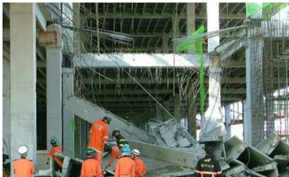
그림 3. A창고 신축공사 중 가설재 붕괴
