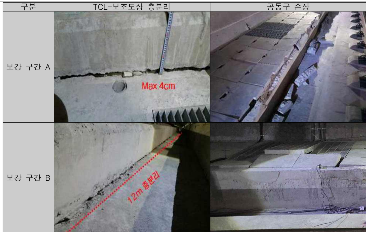
그림 4.2 보수 구간 변상 상태
