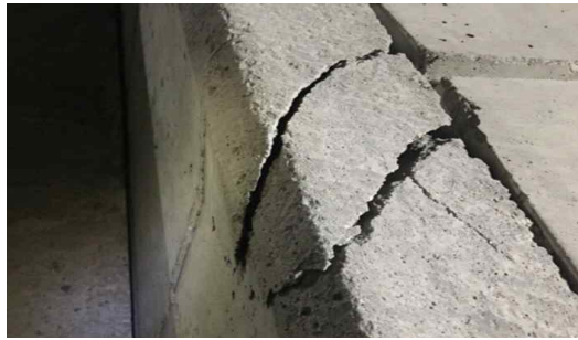
그림 2.66 계측 구간내 공동구 벽체 상부 균열
