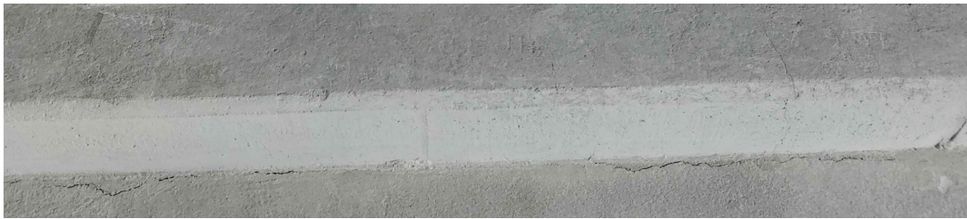
그림 2.12 도상/보조도상 인터페이스 종방향 균열
