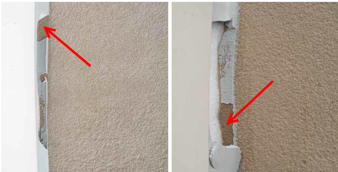
<그림 3.60> Silicone Sealant 와 판재 간 접착성 미확보 확인
