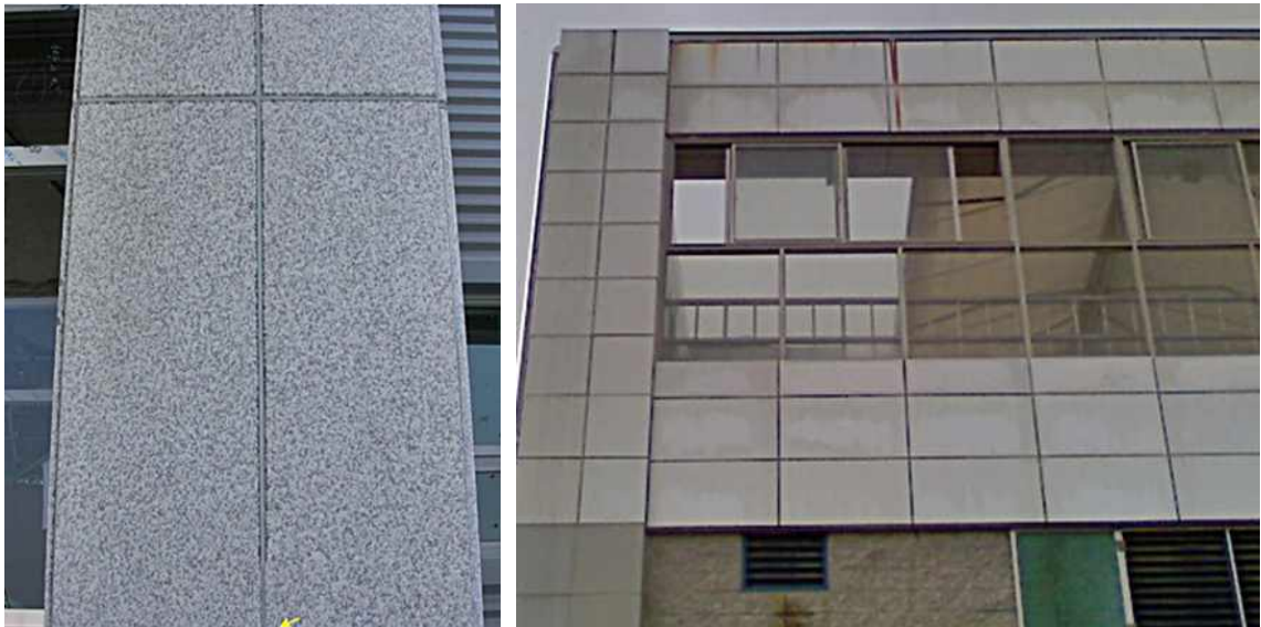
<그림 3.61> 판재 Joint에 Silicone sealant 로 인한 오염 현상 발생
