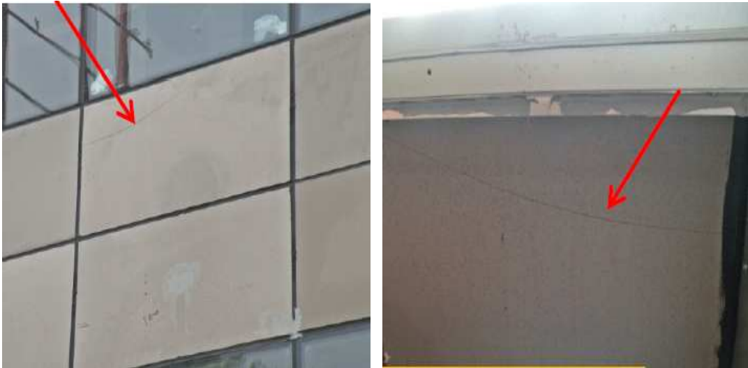
경량발포 패널에 Crack 발생 상태 (좌 : 외부, 우 : 내부)
