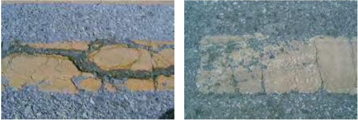
<그림 3.7> 용착식 차선의 Crack 및 마모
