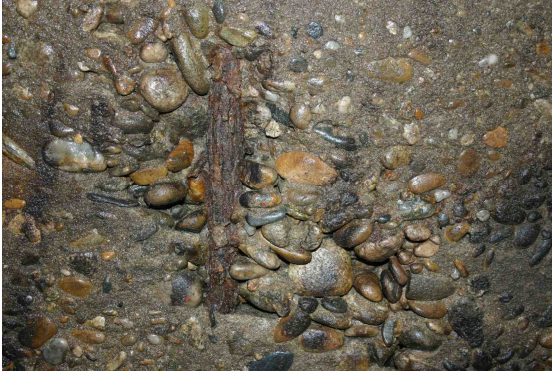
벽체주변의 골재노출 및 철근부식
