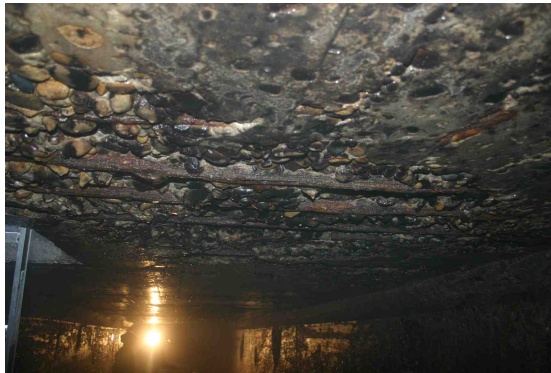
상부슬래브의 철근노출 및 피복탈락
