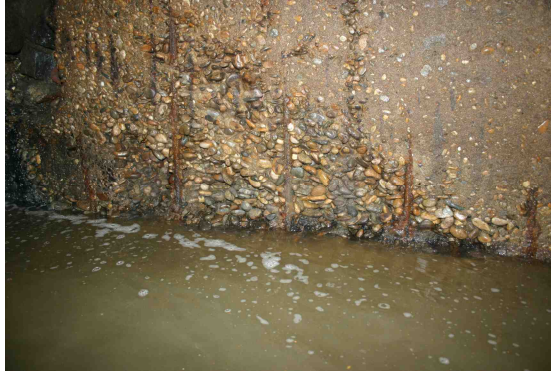
벽체 하단의 침식 및 철근부식
