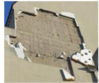
<현장 시공에 의한 외벽 전도>
