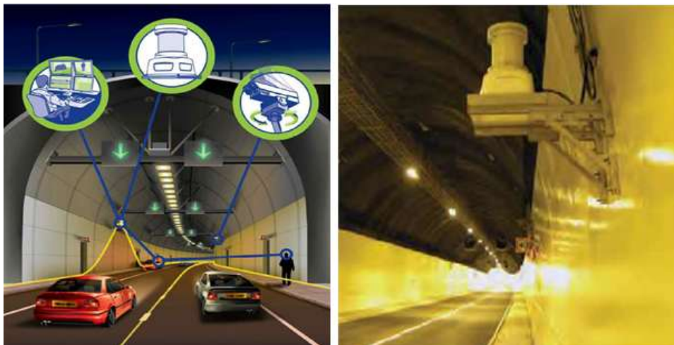
<Navitech사의 레이더 센서 기반 터널 돌발상황 검지시스템>
