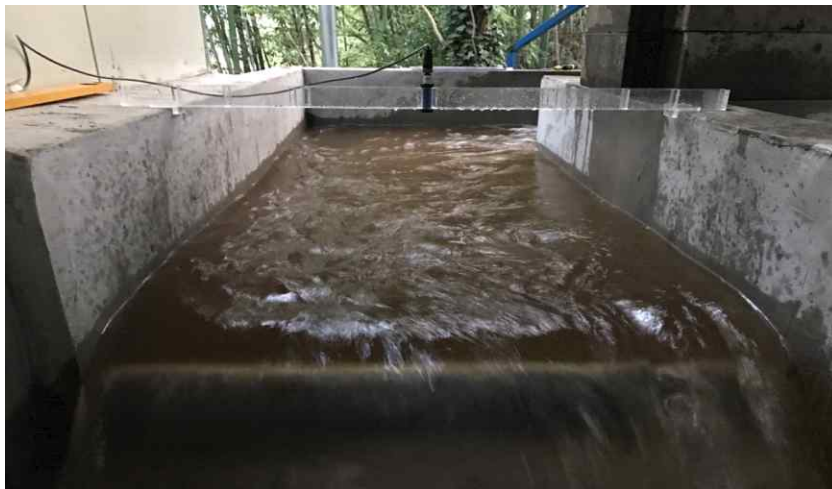
[그림 1.9] 사각웨어 상단에 설치된 초음파 수위계 전경
