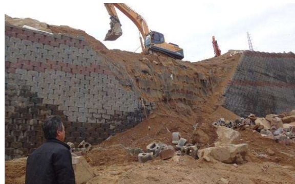
(d) '16 김해나전2산단 보강토옹벽 붕괴
