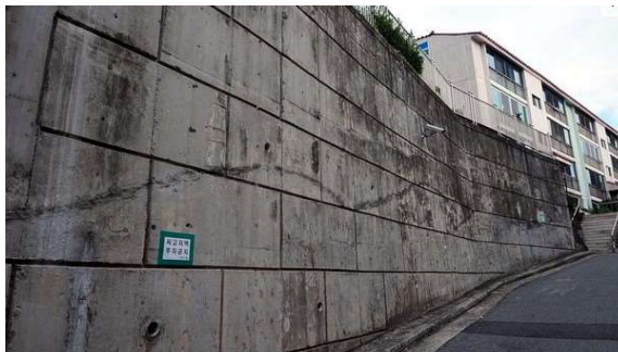
(a) 노후 옹벽 균열 발생 사례
