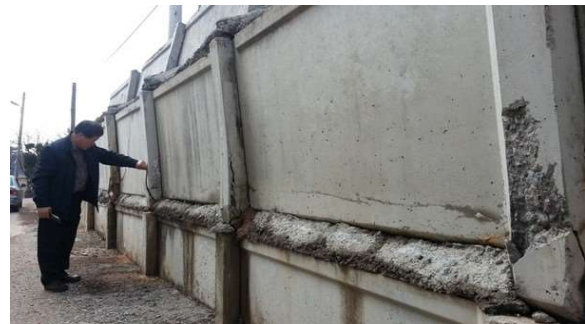
(b) 노후 옹벽의 균열 및 변위 발생 사례
