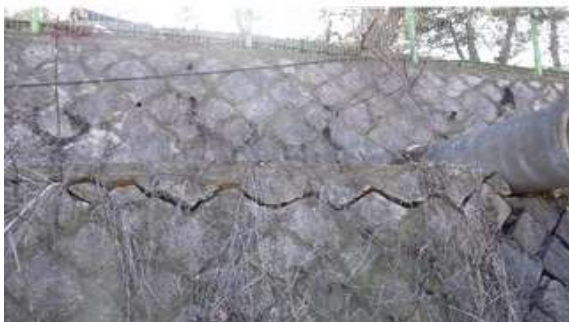
(c) 노후 석축 균열 발생 사례
