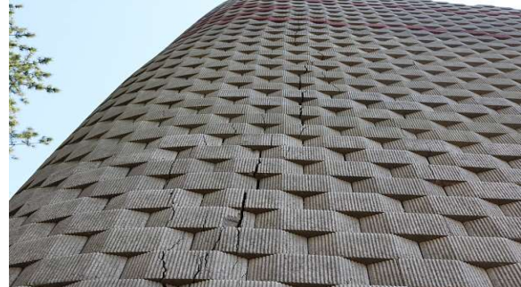
(d) 보강토옹벽 균열 발생 사례
