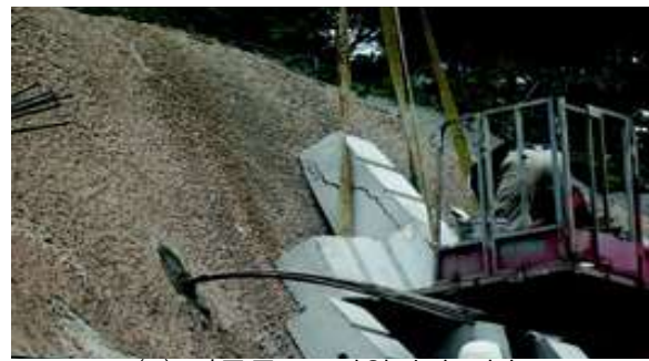
(b) 시공중 RC지압판의 파손
