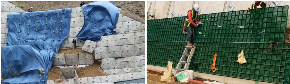
(a) 콘크리트 패널식 옹벽의 유실사례
