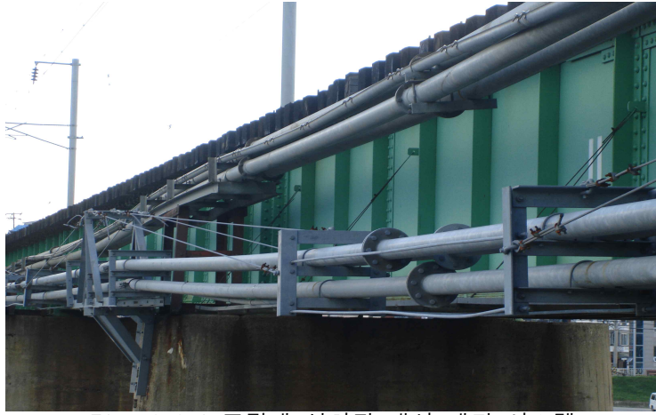
Fig. 3.3.1 교량에 설치된 대상 배관 시스템
