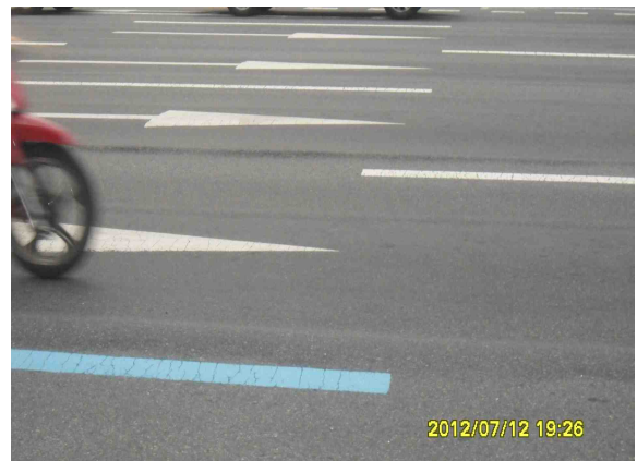
사진 2: 시험포장 위치의 소성변형
