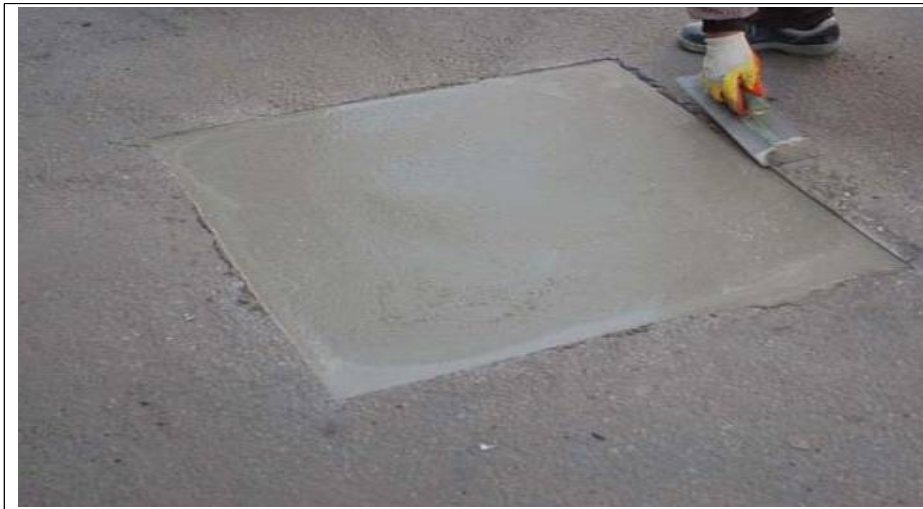
콘크리트 포장 부분보수 가능
